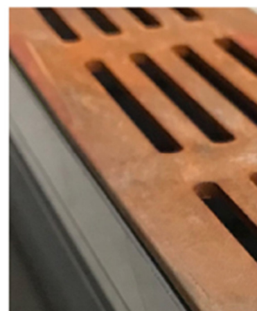
Etat final: patine entièrement développée et stabilisée
